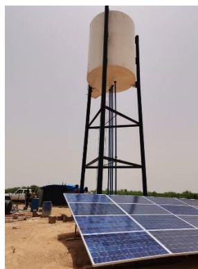
Photo 3. Château d'eau et champ solaire à Gouthioubé
