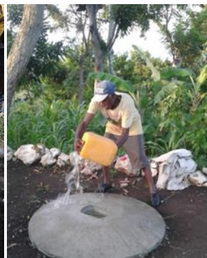
L'arrosage régulier pendant le séchage est déterminant pour la solidité de la dalle
