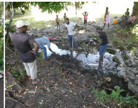
Forte de l'expérience acquise, l'équipe renforce la préparation sociale de la communauté avant le démarrage du captage de Jedipe
