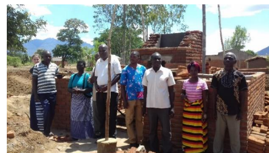
Incinérateur en construction à Kalinde, en présence du comité de suivi du chantier de la maternité, constitué de membres de la communauté
